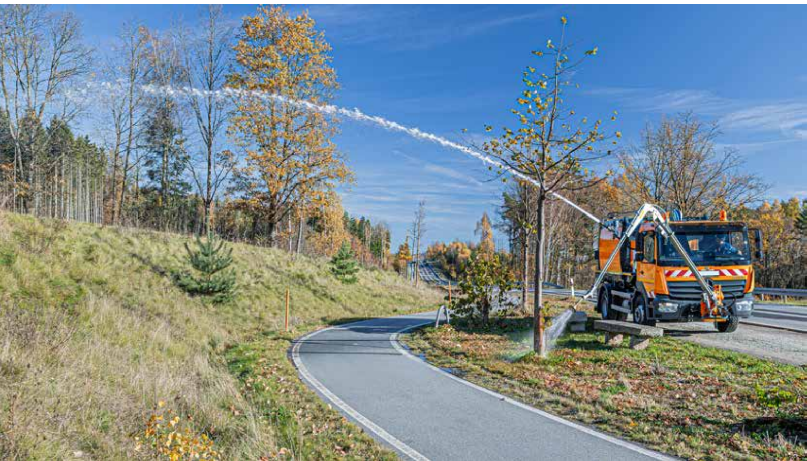
Fiedler Tanksystem FTS 6600 mit Gießarm FGA 1200 und Weit- wurfdüsen am Tank- system
