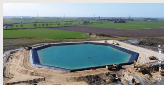
Abbildung 2.5: Erdbecken-Wärmespeicher in der Energie-Kommune Meldorf
