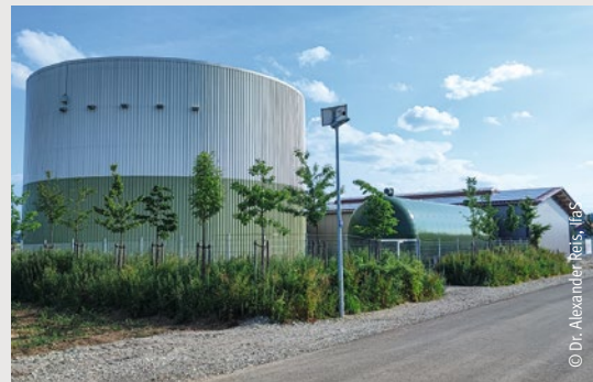
Abbildung 4.17: Großwärmespeicher, Links (5.000 m 3 ) und Kurzzeitspeicher, Mitte (200 m 3 ) zur Wärmespeicherung in der Energie-Kommune Fuchstal
