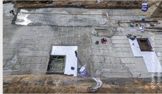
Abbildung 4.24: Erdkollektoren unter Neubauten nutzen oberflächennahe Geothermie
