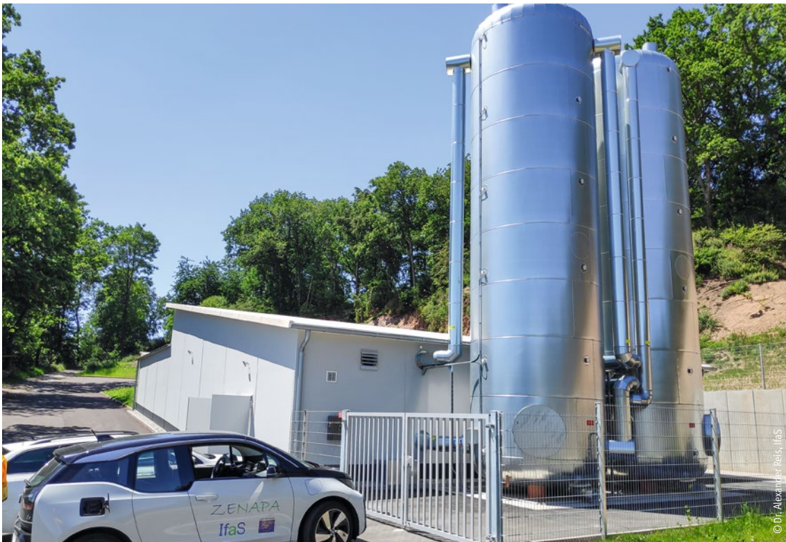
Abbildung 4.16: Wärmespeicher im Bio-Solar-Nahwärmenetz Gimweiler mit Netzspeicher 50 m 3 (hinten) und Solarthermiespeicher 50 m 3 (vorn)
