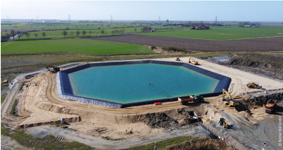
Abbildung 4.19: Saisonalen Erdbeckenspeicher in Meldorf (50.000 m 3 ) zur Speicherung der Abwärme aus einer Biogasanlage und einem Industriebetrieb
