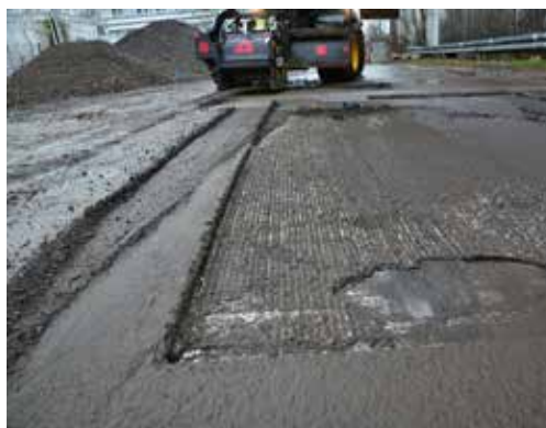
Nach etwa 10 min ist die Schadstelle in der Straße für den frischen Asphalt fertig vorbereitet, ohne dass der Fahrer aus der Kabine aussteigen musste.
