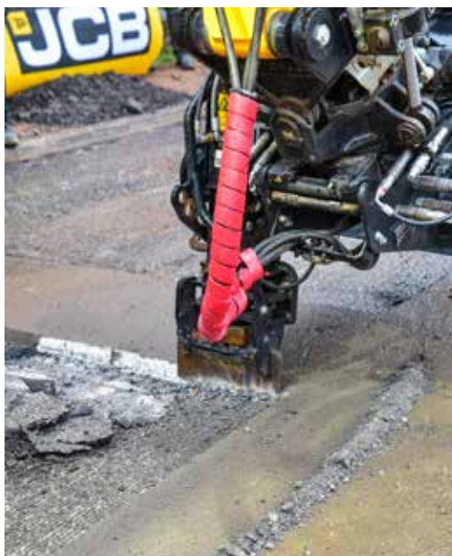
Mit der 400 mm breiten Hardoxklinge werden die Kanten der Schadstelle bearbeitet. Der Hammer arbeitet mit einem Abwärtsdruck von 150 t.
