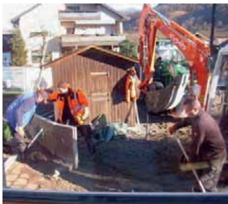
Die Mitarbeiter des Bauhofs helfen auch bei Umbauten an Gemeindegebäuden, wie hier im Kindergarten bei der Vorbereitung der „U3-Betreuung“.
