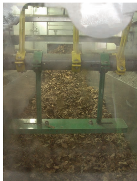
Blick in den mobilen Schubwendetrockner: Hier wird das Laub vor der Brikettierung getrocknet.
